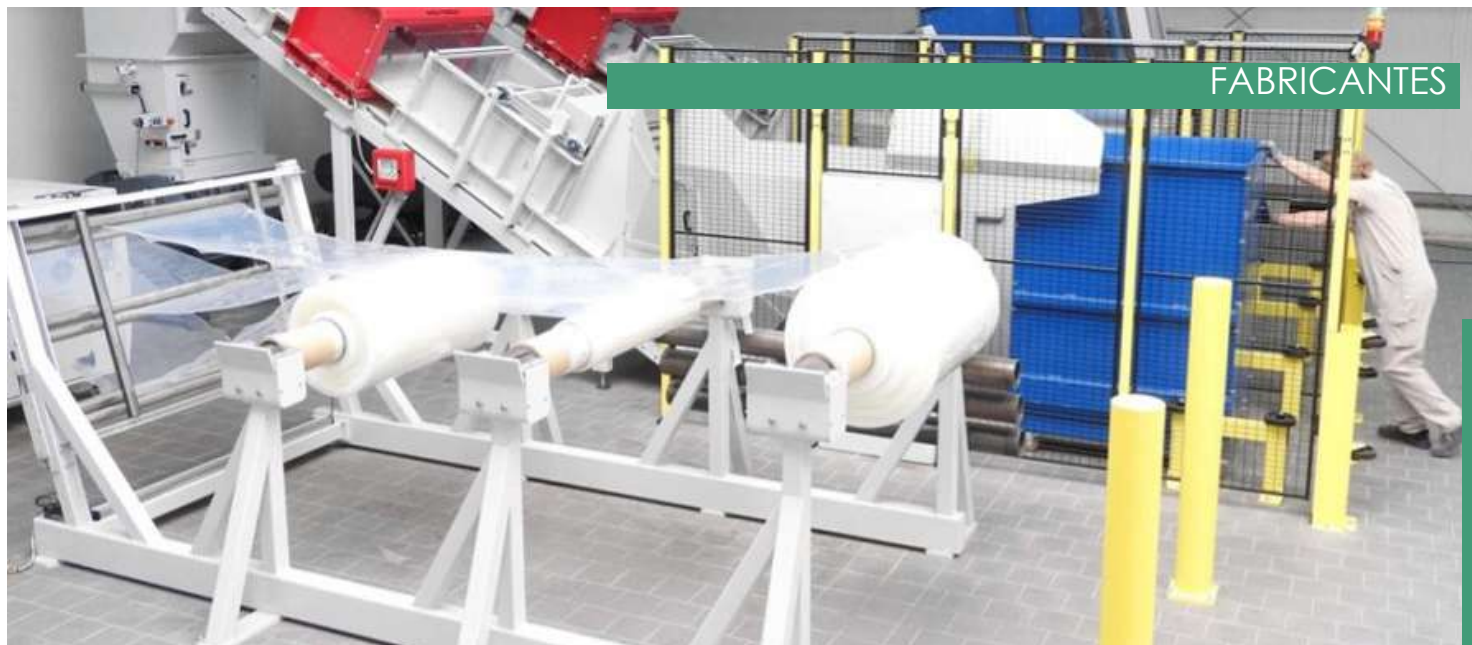
Vista del nuevo centro de granulación de Pro-Pac: En primer plano se puede ver una sección del molino Getecha para residuos de film PP de diferentes grosores; detrás están las dos líneas de Getecha para el triturado de residuos de termoformado apilados.
